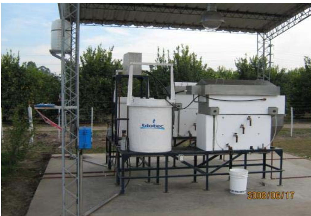
Ilustración 4. Instalación que se utilizó para las pruebas (Planta Piloto)
